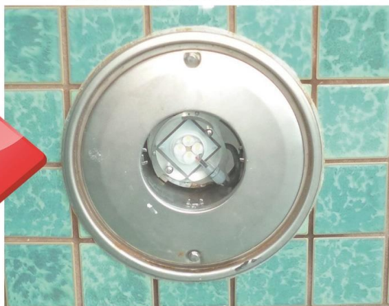
【施工後：弊社LED水中照明】
